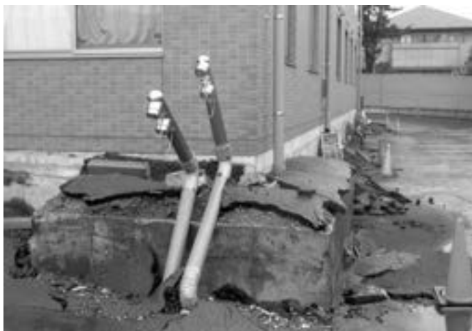
液状化による埋設管被害（熊本市）（消防防災科学センター提供）
