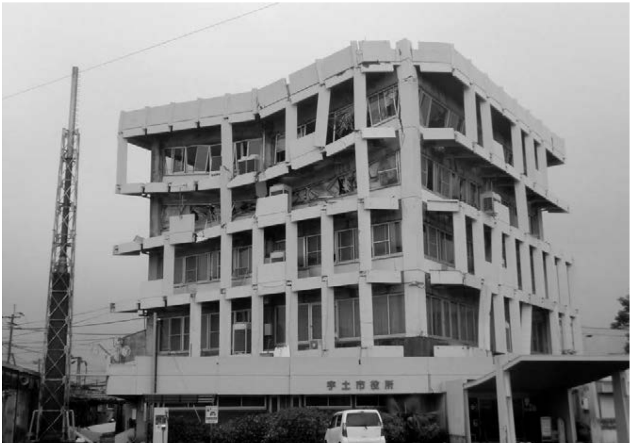
4階部分が潰れた宇土市役所本庁舎（2016年5月9日撮影。消防防災科学センター提供）
