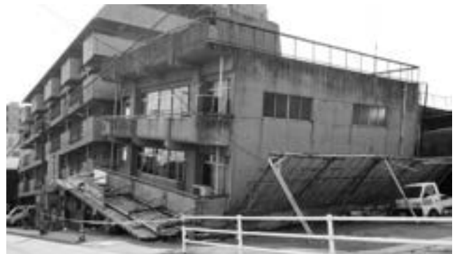
2度の地震で傾いたマンション（京町）
